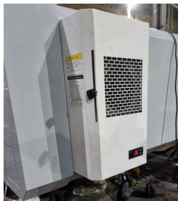
Máy lạnh Tủ Điện+Laser
