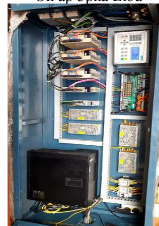
Tủ Điện Điều Khiển
