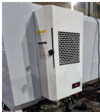
Máy lạnh Tủ Điện+Laser
