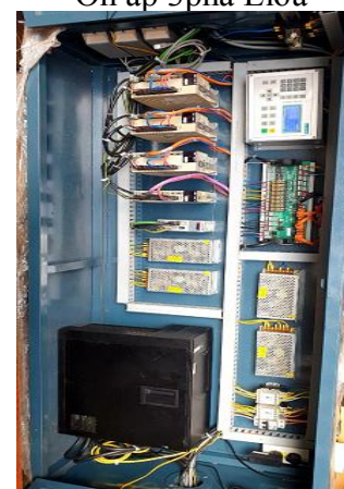
Tủ Điện Điều Khiển
