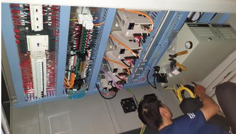
Làm lại tủ điện máy Autoweb-Long Thành-Đồng Nai
